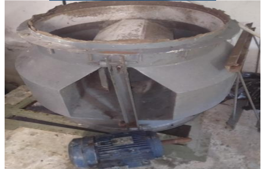
Exhaust Fan STP
